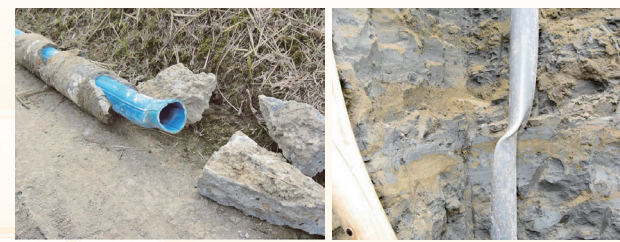
圖 3 傾度管及水位觀測井變形照片
