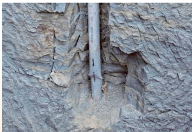
圖 8 試坑調查水位觀測井變形位置
